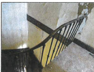
Hauteur garde-corps insuffisante Risque de chute
