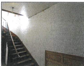
Arrière placage non visible
