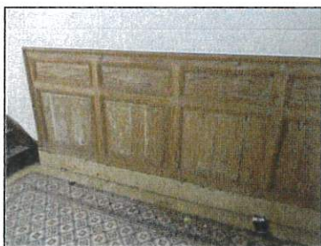
Arrière placage bois non visible
