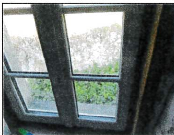
Chambre 2 1er: absence de garde corps risque de chute
