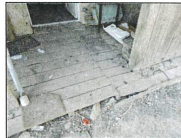
Arrière plancher terrasse non visible
