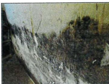
Présence d'humidité importante
